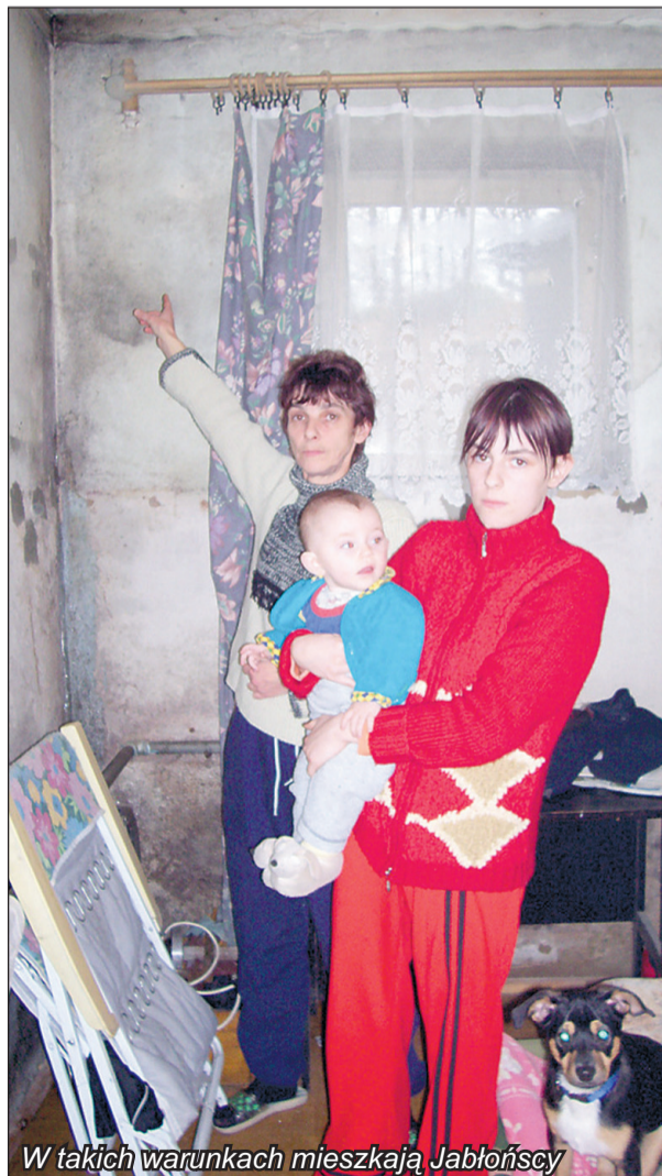
Pani Kamila pokazuje zagrzybioną ścianę przy kaloryferze
